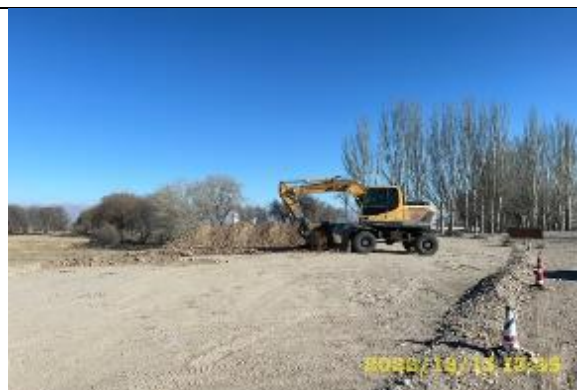
Фото 23. Рытье траншеи и экскавация грунта на км 0+153 (новая круговая) для устройства новой водопропускной трубы
