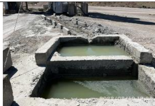
Фото 57. 3-камерный резервуар первичной очистки сточных вод БСУ Лот 1.
